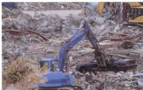
瓦礫の撤去は急ピッチで進むが、この下にはまだまだ行方不明の方々が……。
