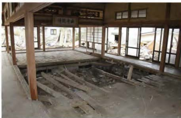
書院は鴨居の上まで水没。欄間の中程に水位を示す痕がくっきりと見える。
