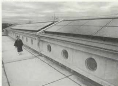
新会館屋上に備えつけられた太陽光発電システム
